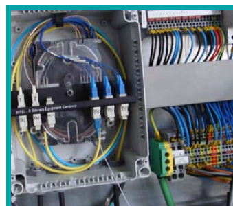
Caja de conexionado de fibra optica perteneciente a un aerogenerador
