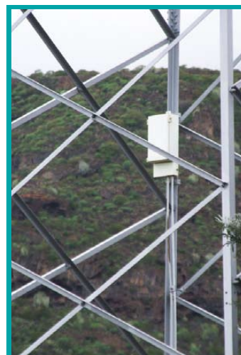
Caja conexionado de empalme por torre de AT
